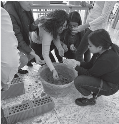
Ilustración 1. Empresa mexicana Novaceramic realizando muro divisorio de tabique cerámico y mortero en las uniones.
